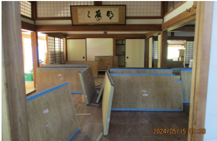
雨漏り対策で畳を上げている様子（祖院）
